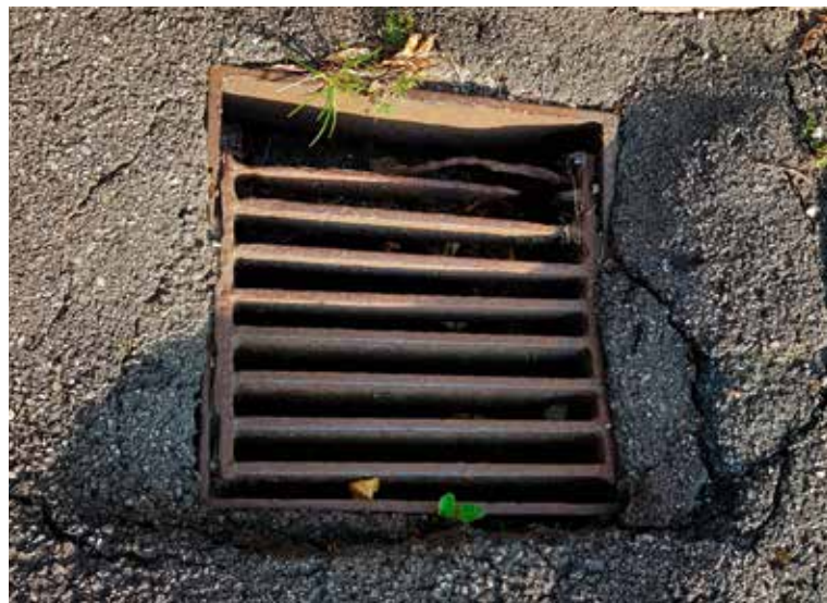
Fotoet ovenfor viser en rist, der ud over at være sunket kraftigt, desuden ligger med risten i forkert retning. Borttæringen i risten betyder, at der rigeligt er plads til, at et cykelhjul kan falde i hullet med et styrt til følge. Bemærk i øvrigt at asfalten er med kraftige revner, der fremmer, at vand kan trænge ned i den underliggende opbygning og medføre yderligere skader som vist på de foregående billeder. Foto: Jørn Bitsch.
